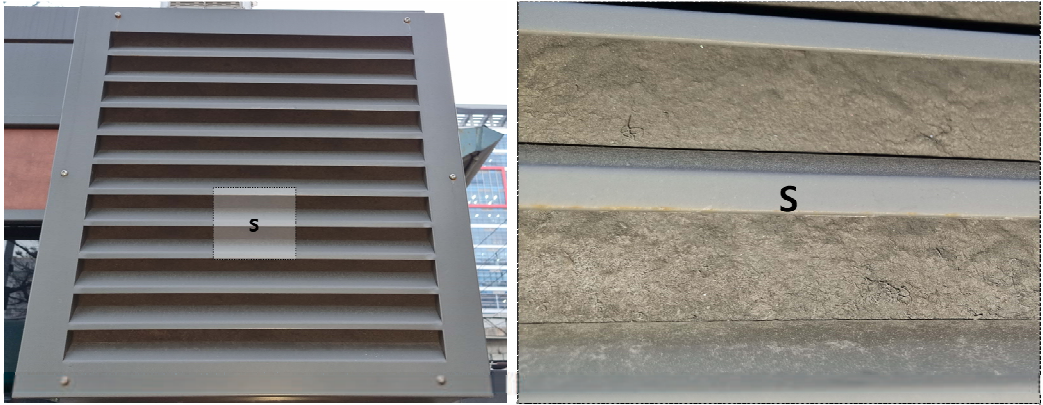
그림 3. 실외에 설치된 여재방식 필터의 막힘 현상
